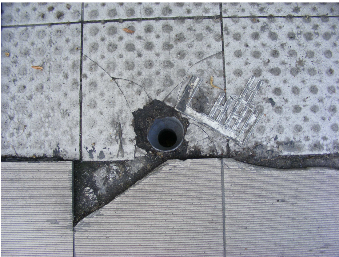
Odwodnienie zagłębienia pod wycieraczką
